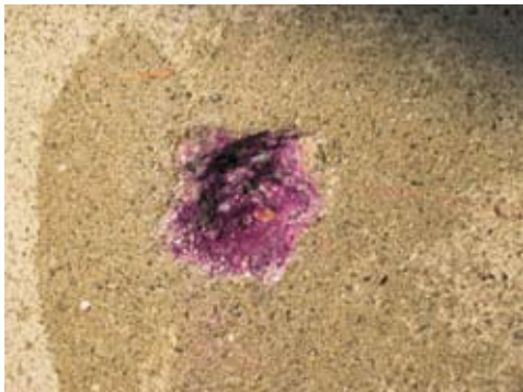
Fig. 15 - Prova alla fenolftaleina sulla colonna A.
