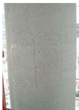
Fig. 6 - Esempio di fessurazione sulla superficie di una colonna.
