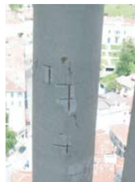
Fig. 7 - Esempio di distacchi di copriferro su una colonna.
