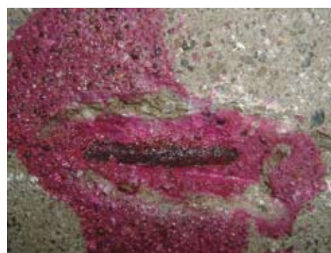
Fig. 13 - Prova alla fenolftaleina sul calcestruzzo, vicino a una armatura sulla colonna C, dopo il trattamento.
