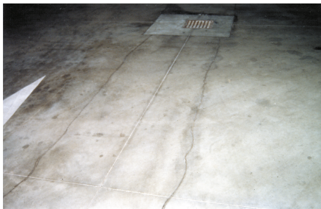
Fig. 1 - Dissesto della pavimentazione per inefficace compattazione del terreno nello scavo effettuato per il posizionamento dei tubi di raccolta dell'acqua
