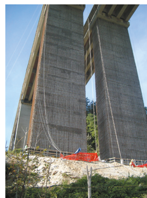
Fig. 9 - Vista d'insieme delle pile dei ponti scarificate prima di applicare l'SCC a ritiro compensato come in Fig. 7
