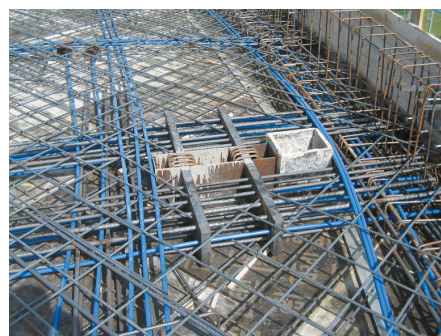
Fig. 7 - Esempio di congestione di armature metalliche nel getto dei solai nel Trade World Center di San Marino
