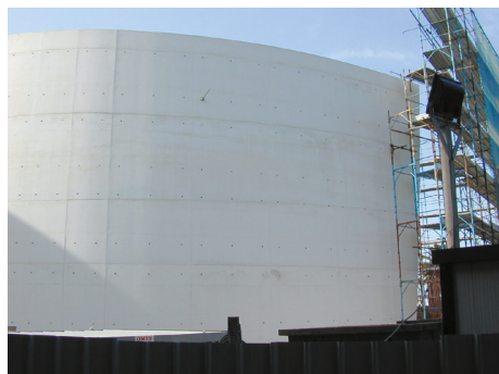
Fig. 1 - Le vele bianche in SCC in fase di esecuzione per la Chiesa di S. Pietro Apostolo di Pescara
