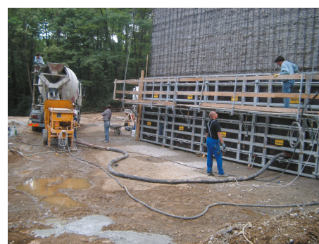
Fig. 10 - Fase di getto dell'SCC a ritiro compensato pompato e gettato entro casseri
