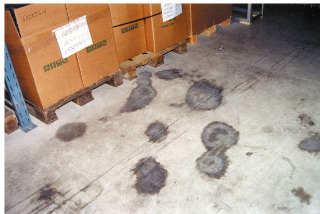
Fig. 4 - Chiazze di umidità per risalita di acqua dal sottofondo in presenza di un vespaio realizzato con materiale non idoneo
