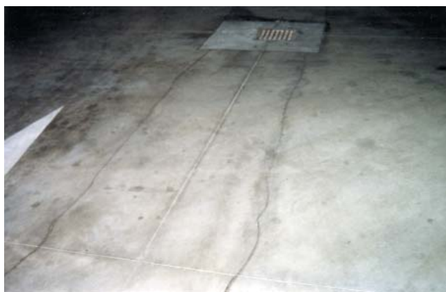
Fig. 1 - Dissesto della pavimentazione per inefficace compattazione del terreno nello scavo effettuato per il posizionamento dei tubi di raccolta dell'acqua
