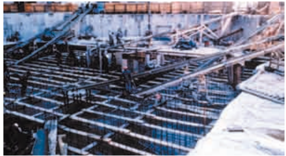
Fig. 3 - Getto di calcestruzzo neoplastico in assenza di vibrazioni per la fondazione di un grattacielo a New York (USA) nel 1979.
