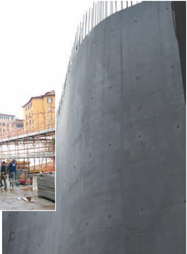
Fig. 10 - Muro alto e curvo, del MAXXI, Roma, privo di giunti di contrazione per l'impiego di agente espansivo e di additivo SRA (Giuseppe Marchese, Calcestruzzi Spa).
