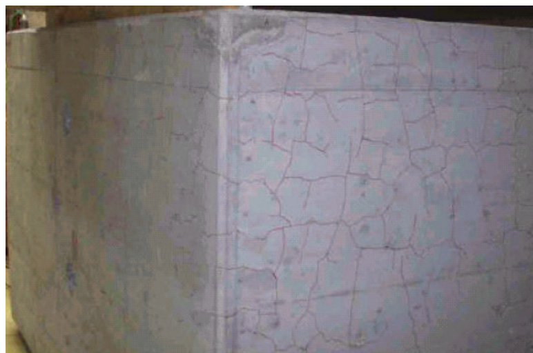
Fig. 7- Una parete del modulo n. 1 con microfessurazioni superficiali evidenziate con il pennarello rosso. Trattasi di microfessurazioni di apertura sensibilmente inferiore al 0.1 mm, che interessano uno strato di profondità dell'ordine del mm.
